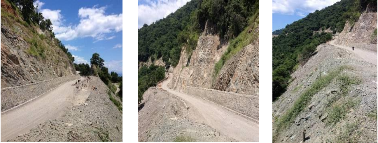
Figura 40 – imajem tolu nee hatudu dizafius neebe hasoru husi konstruidor Estrada iha prinsipais Estrada Dili – Batugade Road. Suco Vatuboro, Kaptasaun Agregando Sanakiana
