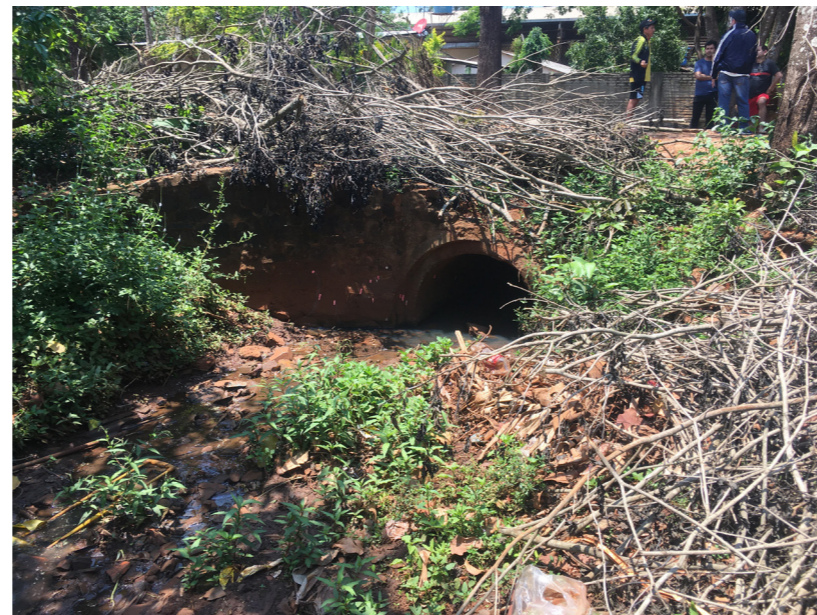
Tubos existente colmatados y taponados con basura
