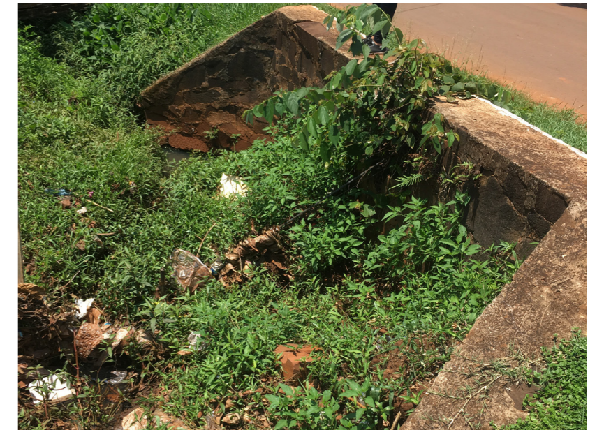
Tubos en calles colmatados
