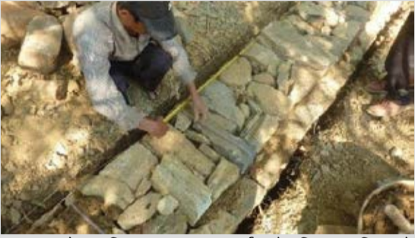
०३ गारो जमिन सतहमा आईसकेपछि प्लाष्टिकले छोपिएको जस्ता तारको 'क्रस लिंक' राख्ने । यो ढोका र भूयाल पर्ने ठाउँको दुबैतिर राख्ने । गारोको भित्रपट्टी ३ इञ्च छोडेर राख्ने ।
