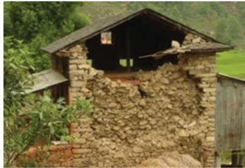
वारपार ढुङ्गा प्रयोग नगरिने आम प्रचलनले गारोको एक पत्र वा तह तस्वीरमा देखाईएभैं भत्कन सक्छ । यसो नहोस् भन्नाका लागि गारोमा वारपार ढुङ्गाको उचित प्रयोग गर्नुपर्छ ।
