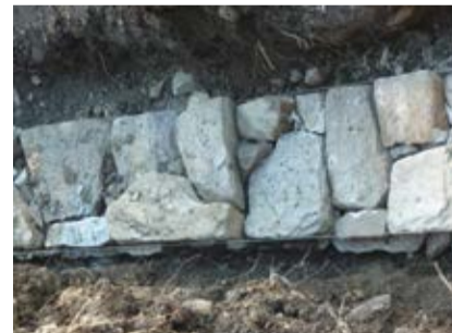
०४ तस्वीरमा देखाईएभैं लामालामा वारपार ढुङ्गा (केजी माने ढुङ्गा) को प्रयोग गर्नुपर्छ । यसले गारोको एक पत्र भत्कनबाट जोगाउँछ ।
