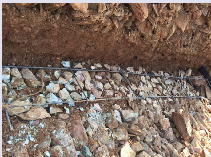
खराब गुणस्तरको जग निर्माण
