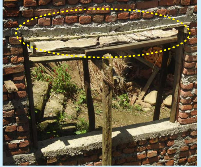
खुला भागको चौडाई धेरै भएको र लिन्टेल बन्धनले भार लिन नसकेको अवस्था
