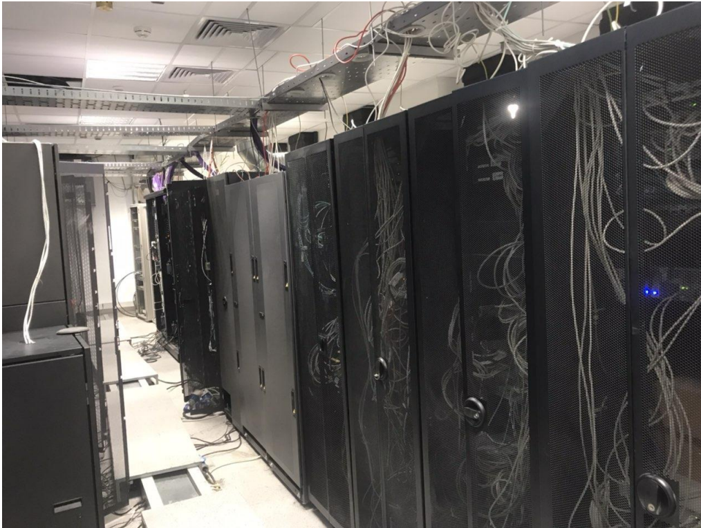
Slika 5. Pasivne mrežne instalacije u DataCentru
