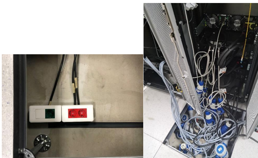
Slika 11. Napajanje rack ormara u okviru DataCentra
