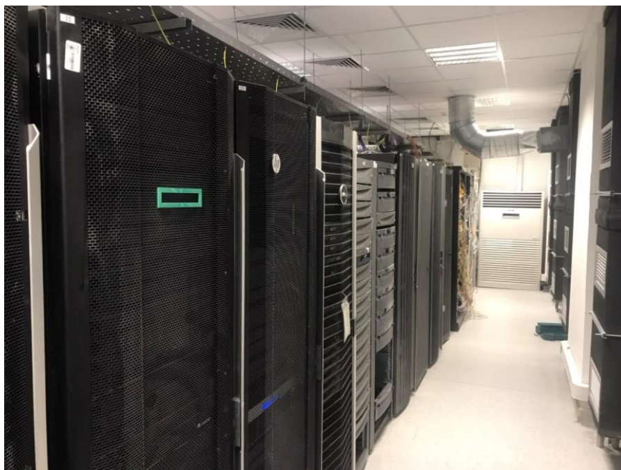
Slika 4. Jedan niz rack ormara u DataCentru
