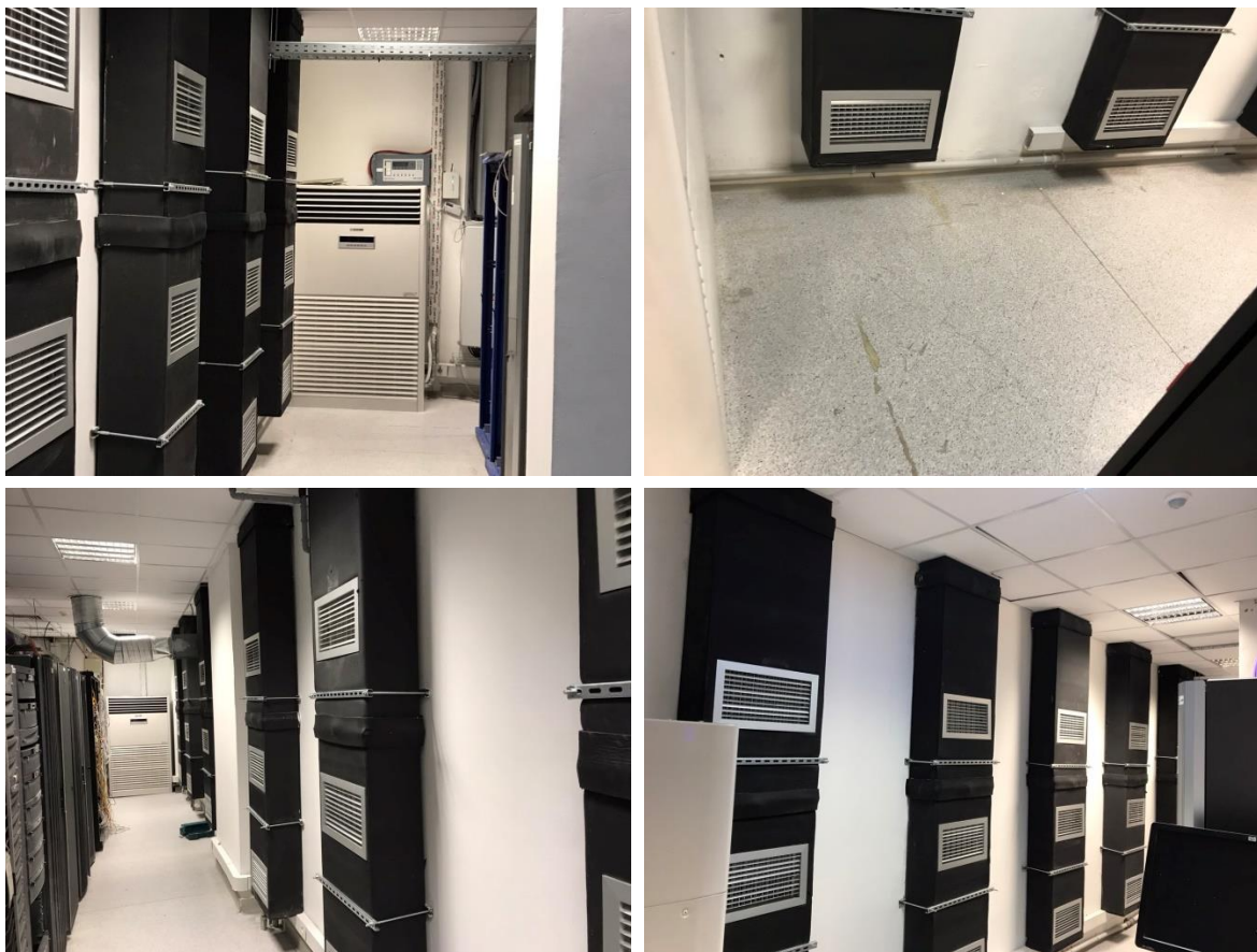
Slika 6. Termo-tehnički i mehanički sistemi u DataCentru
