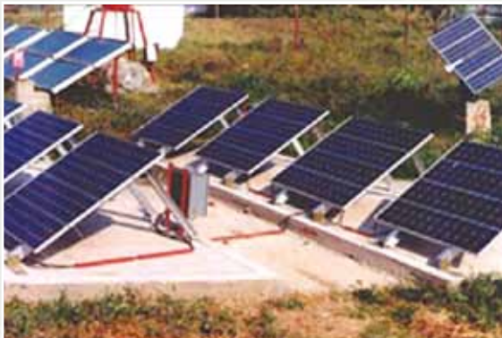
Fig. 63. Stație pilot termofotovoltaică pentru o fermă țărănească din România
