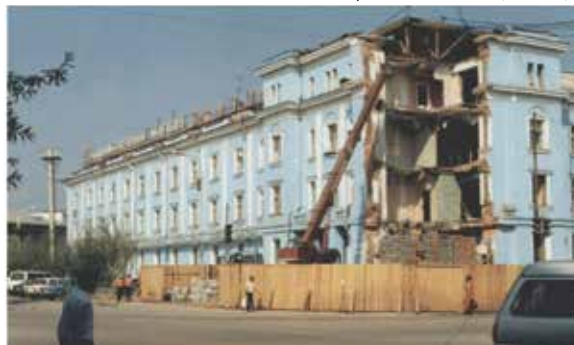
Fig. 2.8.11. Prăbușirea colțului clădirii, centrul orașului Yakutsk (Rusia).
