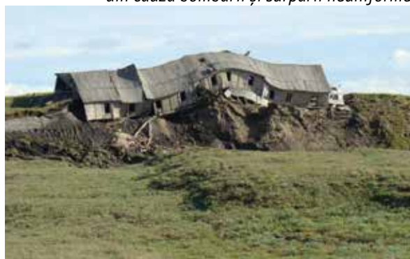
Fig. 2.8.9. Clădirea unei unități militare, distrusă din cauza bombării și surpării neuniforme.
