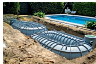
Underground Modular PE tank
