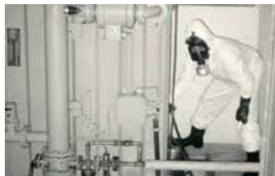
Foto 32. El drenado de un transformador con PCB.
