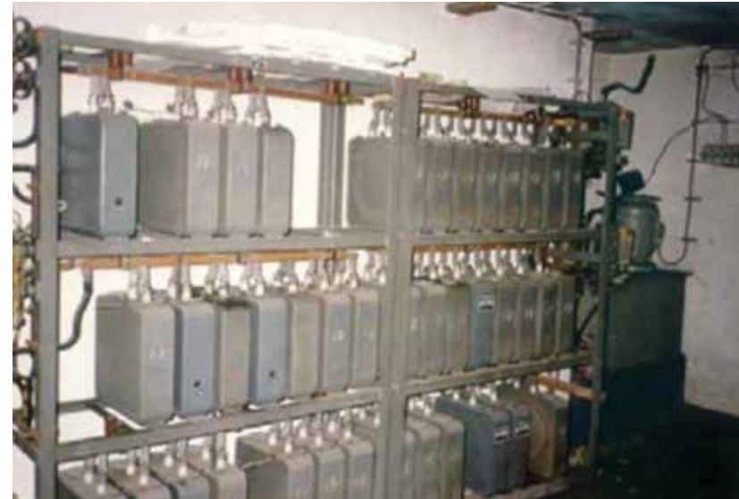
Foto 2. Sistema cerrado-banco de capacitores.
