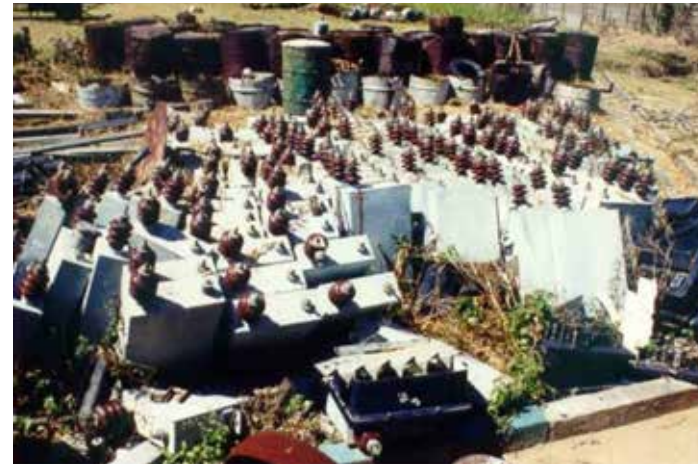
Foto 53. Ejemplo de un almacenamiento incorrecto (al aire libre).
