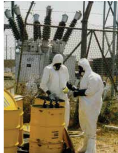
Foto 37. Empaque de capacitores con fuga en tambores UN.
