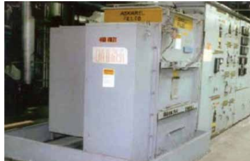
Foto 24. Sistema de contención de metal.
