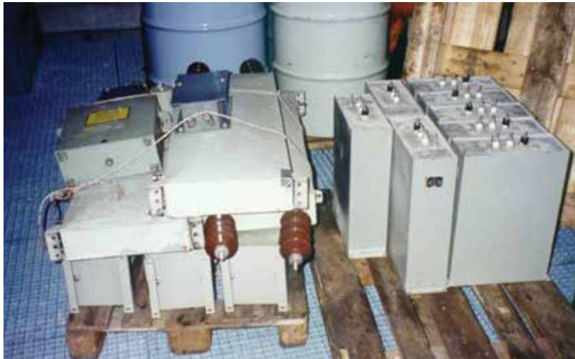
Foto 36. Ejemplo empaque y almacenamiento no apropiado.
