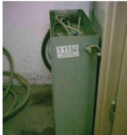
Foto 35. Capacitor inventariado y etiquetado.
