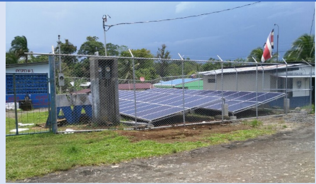
Paneles solares ASADA Colonia San José
