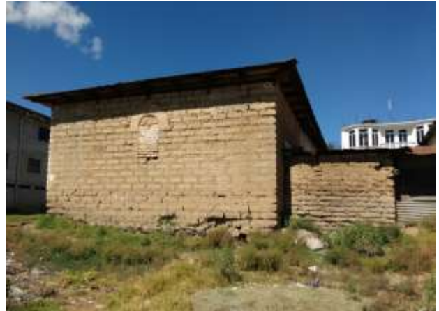
Parte posterior de adobe y daños.
