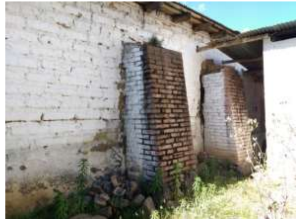
Vista de Contrafuertes laterales y daños
