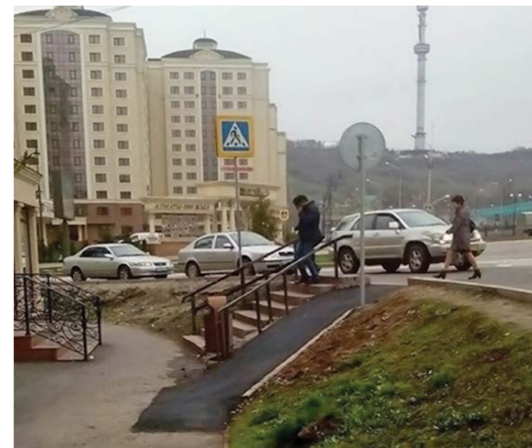
Пандусы, не соответствующие строительным нормам
