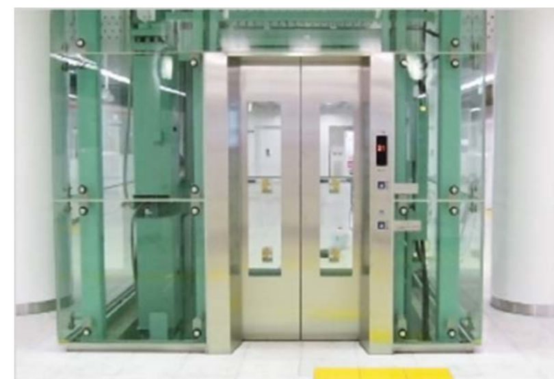
Лифт в метро г. Токио.
