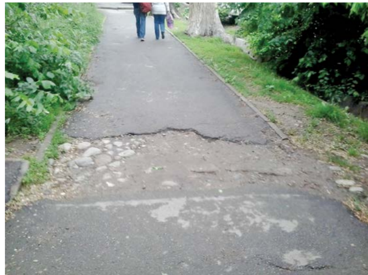
Плохое качество состояния дорожного покрытия на тротуарах
