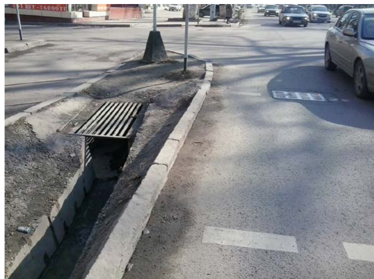
Отсутствие сопряжений между тротуарами и пешеходными переходами
