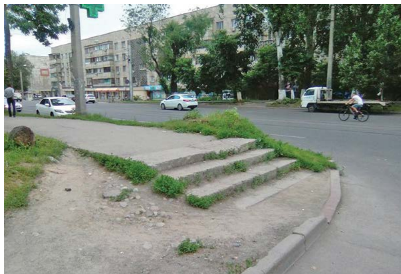
Отсутствие пандусов на тротуарах
