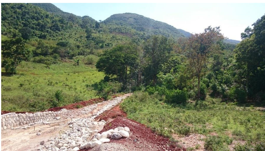
Fig. 13. Fossé de drainage issu de la route et conduit vers une doline pour évacuation des eaux
