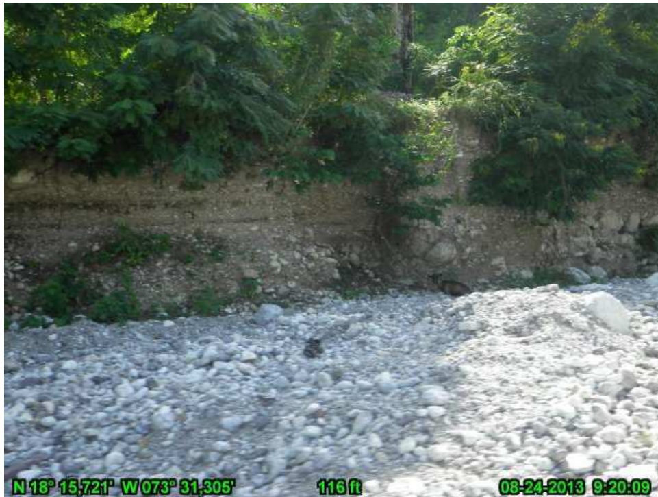
Photo 7.3 Talus d'érosion sur la berge de la Ravine du Sud à la hauteur de Bas Camp-Perrin
