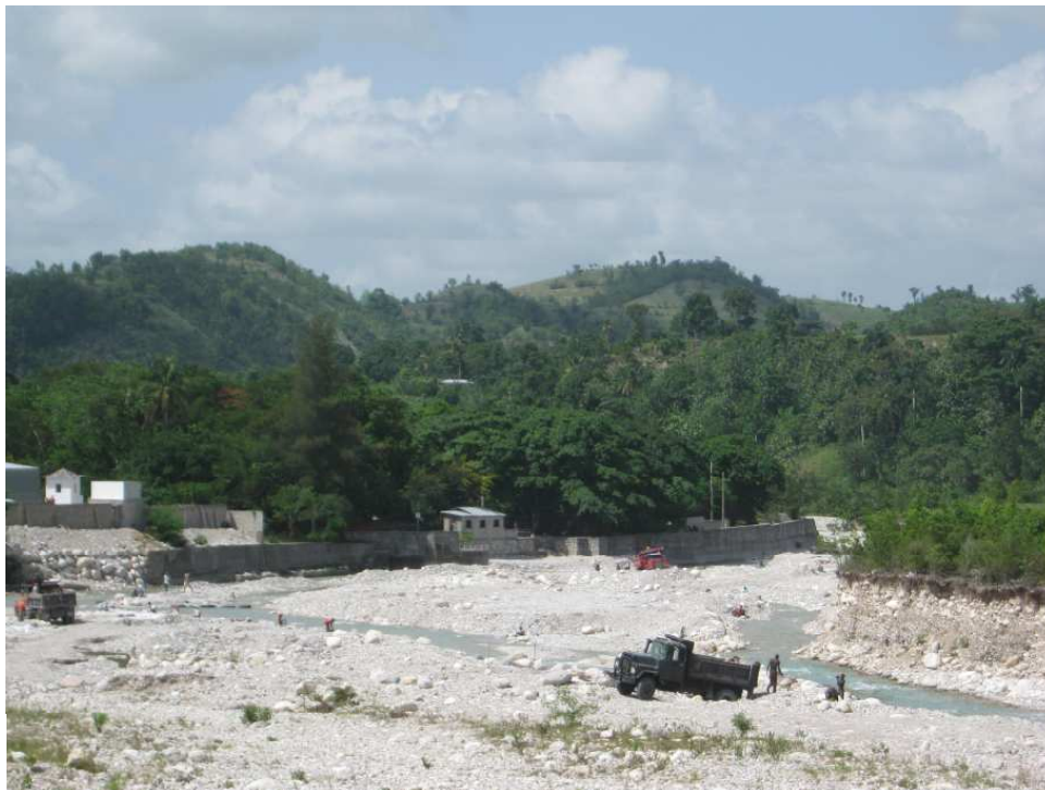
Photo 7.20 Prélèvement de matériaux de construction dans le lit de la Ravine du Sud dans le secteur du Bas Camp-Perrin
