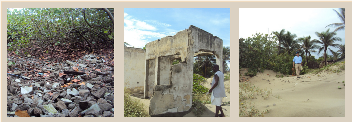
Acumulación de desechos de la demolición de viviendas, obstruyendo la dinámica dunar.
