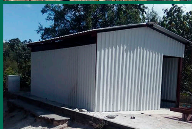
Construcción de infraestructura productiva para resguardo del equipo del beneficio de café. Chel, Chajul. Fotografías PC-DRI - Ixil / Diego Pú
