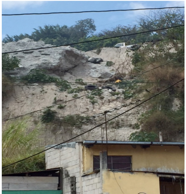
Fotografías 9 y 10: Colapso de talud Km 10.8, zona 18, Carretera al Atlántico, Guatemala y sector La Pinada, Santa Lucía Milpas Altas, Sacatepéque. Fuente: SE-CONRED.
