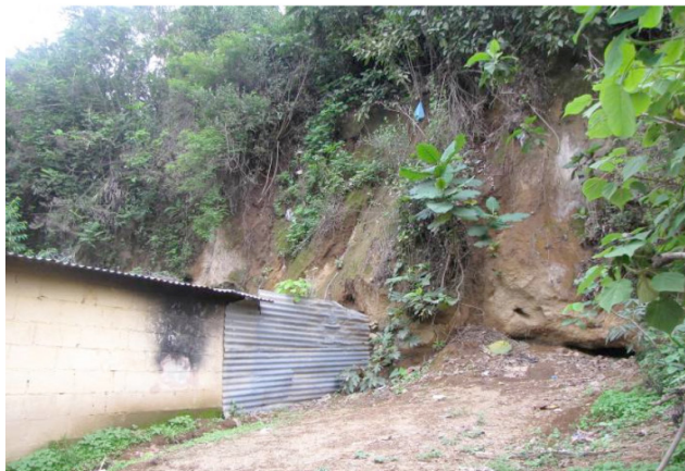
Colapso de talud Km 10.8, zona 18 Fuente: SE-CONRED.
