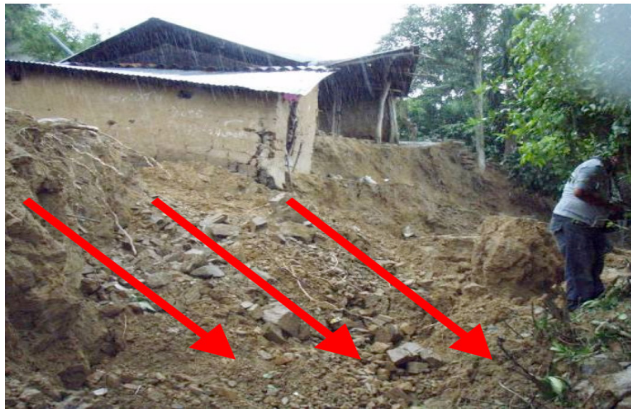
Fotografía 8: deslizamiento de ladera por movimiento de masa en Aldea El Jute, Huité, Zacapa Fuente: SE-CONRED.
