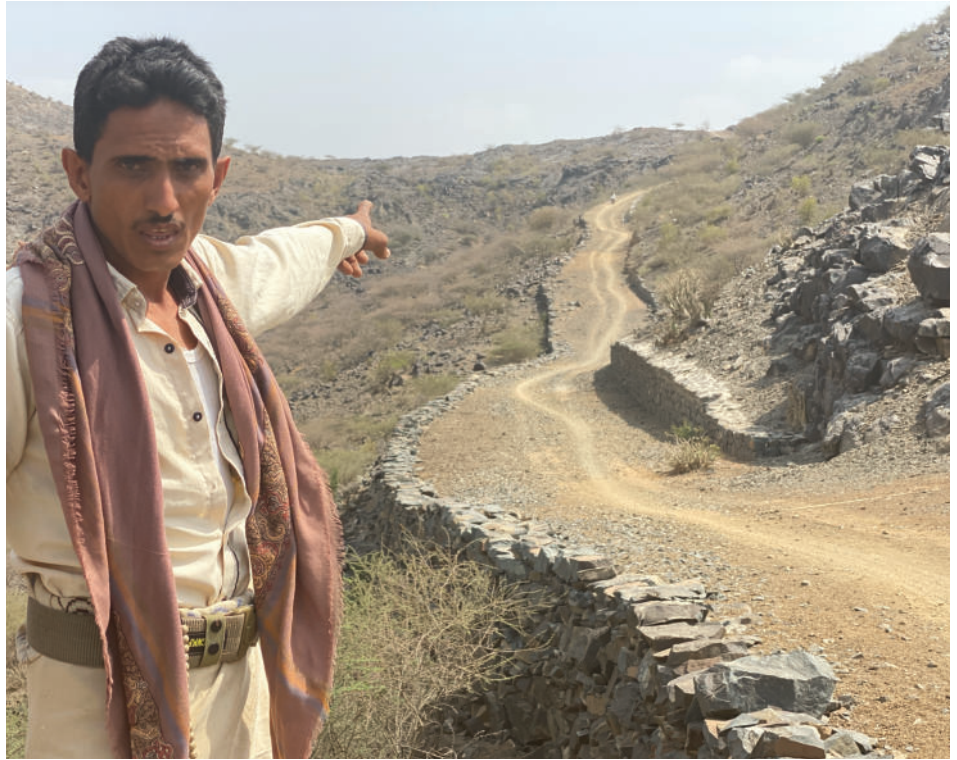
عادل وهو يشير إلى الطريق الذي أعيد تأهيله في وادي المرخ ، بأجل ، الحديدية
