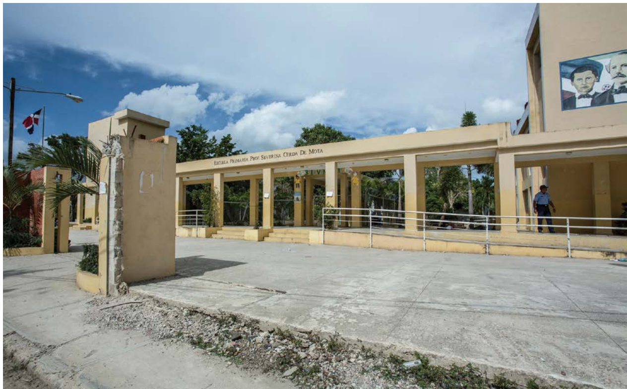
Muro perimetral de la escuela Severina Cerda de Mota destruido. Foto 31.
