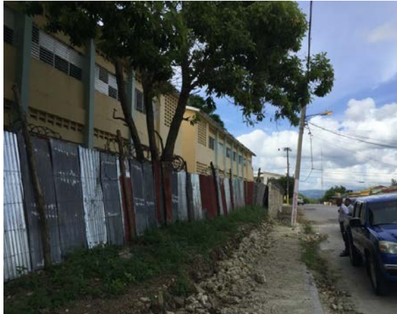
Escuela Manuela Diez Jiménez afectada en su muro perimetral. Foto 29.
