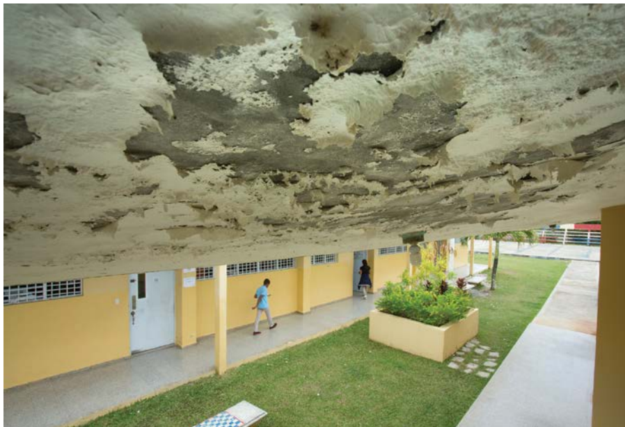
Techos de escuelas afectadas. Foto 28.
