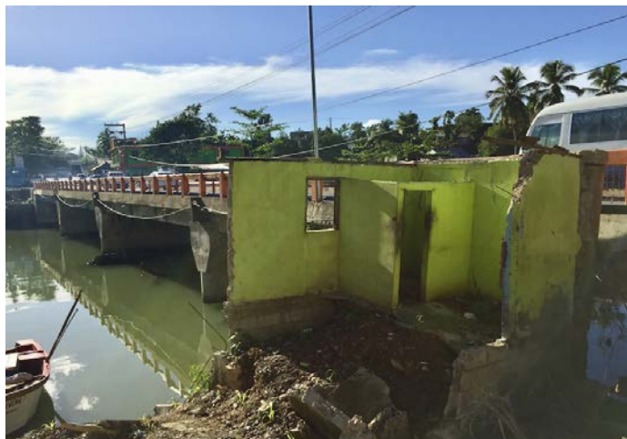
Viviendas destruidas en La Yeguada, Miches. Foto 27.
