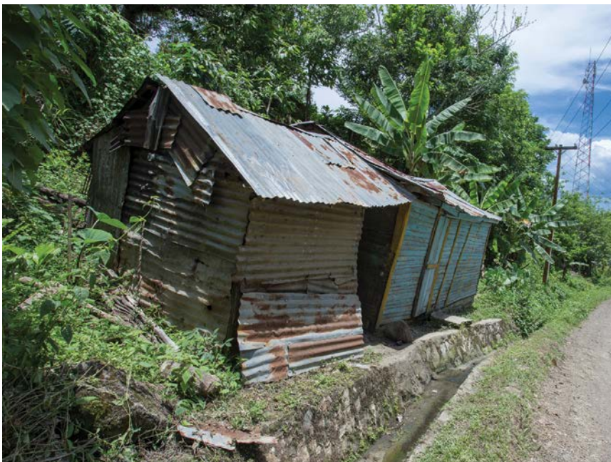
Mala calidad de paredes y techos como factores de vulnerabilidad. Foto 18.
