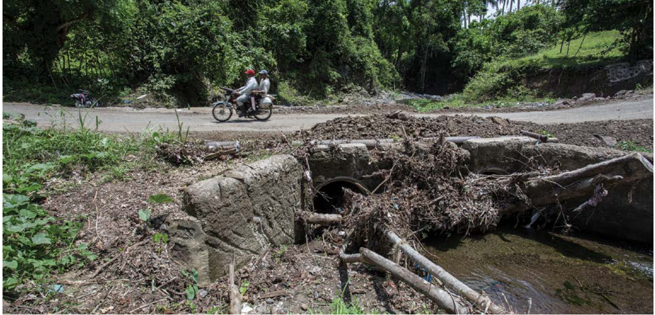
La falta de mantenimiento agrava las condiciones de los badenes, alcantarillas y puentes .Foto 20.
