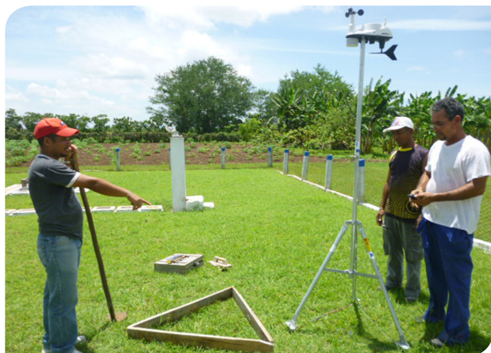
Instalación de estación meteorológica portátil en una estación hidrológica operada por observadores voluntarios
