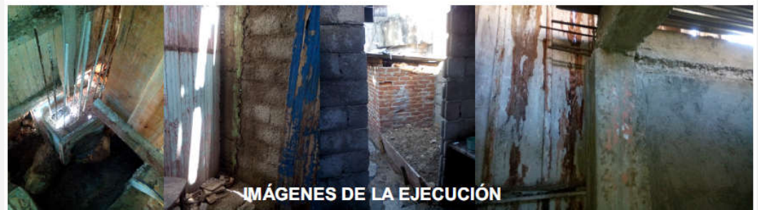
Rehabilitación y ampliación de interiores. Edificación para viviendas de interés social. Calle Trocha No. 706.
