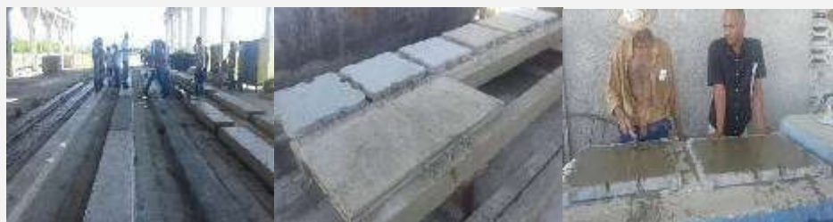
Producción de losa canal y vigueta y plaqueta en Contramaestre/Producción de vigueta y plaqueta y losa canal en Palma Soriano
