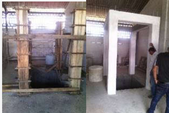
Ejecución de foso para inmersión para el curado de losas de pisos en Songo La Maya
