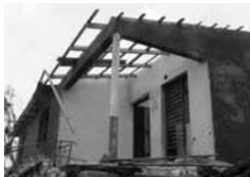
Vivienda en el poblado de La Bajada, Pinar del Río, afectada por el huracán Iván de categoría 5, en septiembre de 2004.
