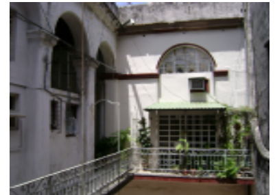
Intervenciones populares en ciudadelas: transformación de fachadas, construcción de barbacoas y ampliaciones en áreas comunes
