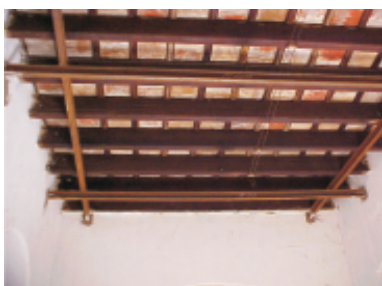
Acciones de reforzamiento estructural de vigas de madera y sustitución de cubiertas en mal estado
