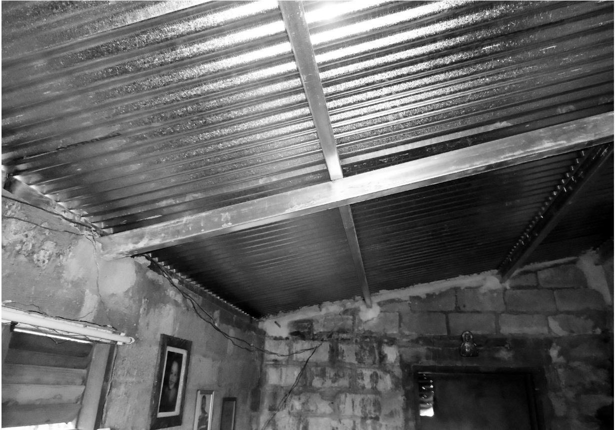
DETALLE DE CINTA DE AMARRE EN VIVIENDA INTERVENIDA.
