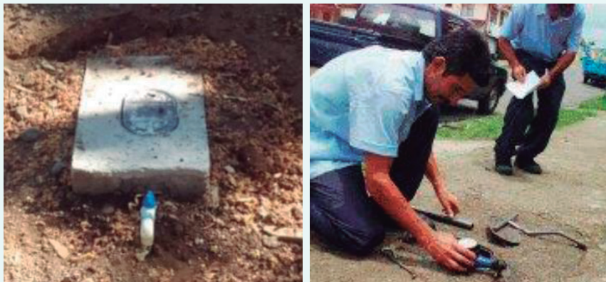
Figura 2. Detalle de instalación y lectura de un micromedidor.
