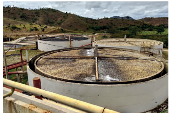
Figura 6 - Distribución desigual de agua residual en FBP como consecuencia de la obstrucción de orificios y/o atascamiento de brazos rotatorios.
