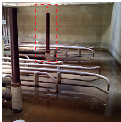
Figura 4 – Tubería de descarte de lodo posicionada muy cerca del deflector de gases, en discordancia con el diseño.
