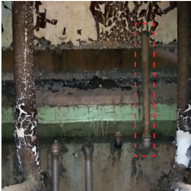
Figura 3 – Instalación del punto de muestreo encima del límite del compartimento de decantación, en discordancia con el diseño.
