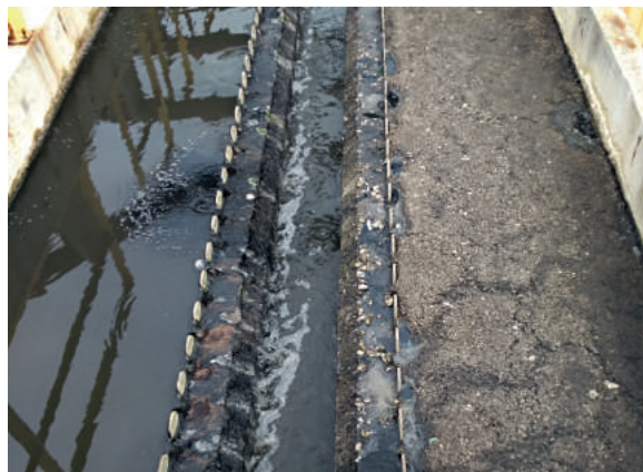
Figura 4 - Acumulación de nata como consecuencia de vertedores desnivelados.
