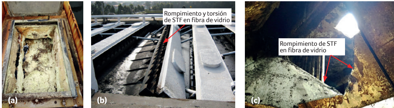
Figura 11 – (a) Nata solidificada en el interior de un separador trifásico; (b y c) Rompimiento del separador trifásico.
