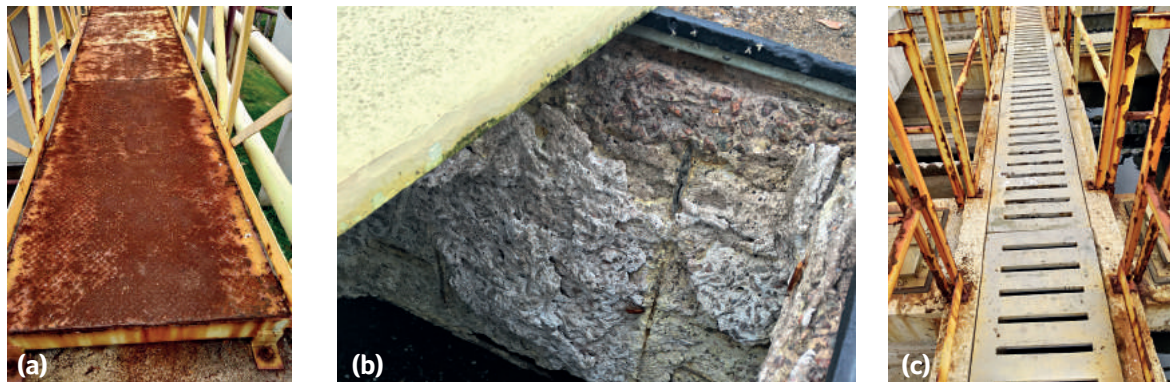
Figura 2 - Fotos de detalles de la corrosión en: a) pasarela metálica; b) estructura de concreto; c) estructuras metálicas de barandas.
