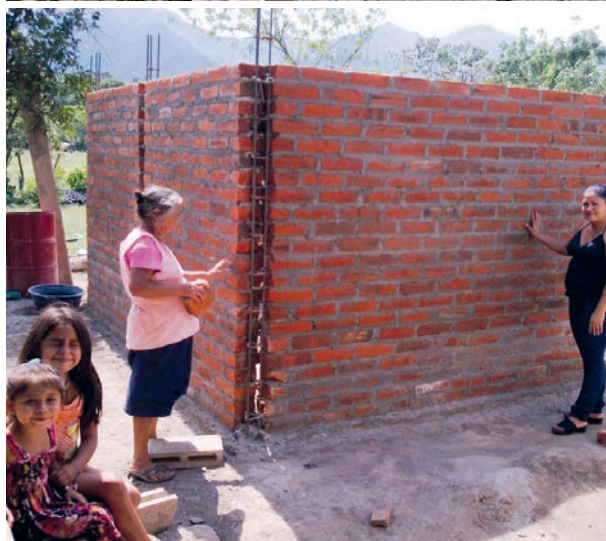
Proceso de construcción de casa del agua. (Fuente: Juan René Guzmán, El Salvador).
