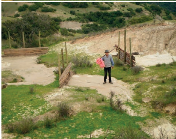
Prácticas de conservación: construcción de disipadores de energía para evitar la erosión por escorrentía.
