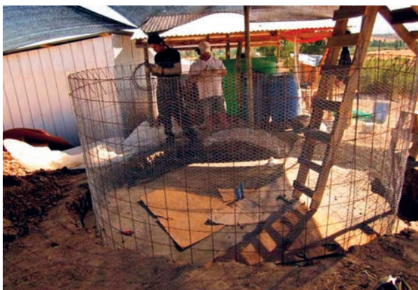
Estructura metálica resistente a sismos en depósitos de almacenamiento en Chile. (Fuente: Jorge Carrasco, INIA).
