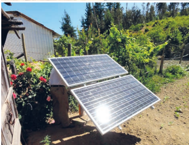
Sistema fotovoltaico para proporcionar energía para la distribución de agua. (Fuente: Roberto Pizarro, Universidad de Talca).
