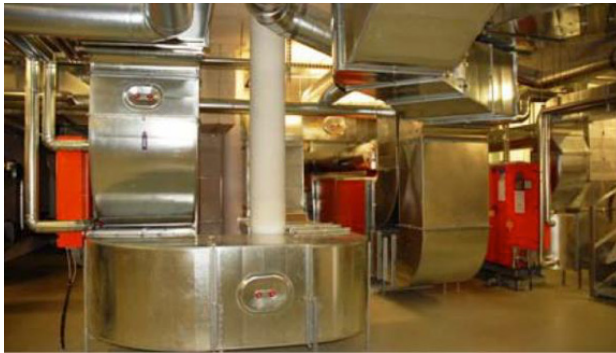
Рис. 29. Крупная централизованная система МВРТ требует для работы помещения большой площади 17 .
