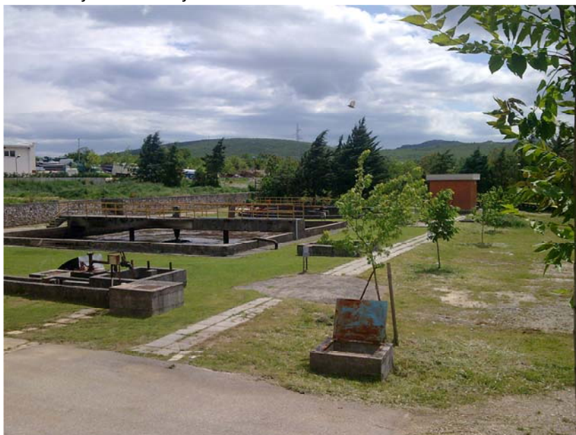
Slika 5.3 Postrojenje za prečišćavanje otpadnih voda Ljubuški, BiH
