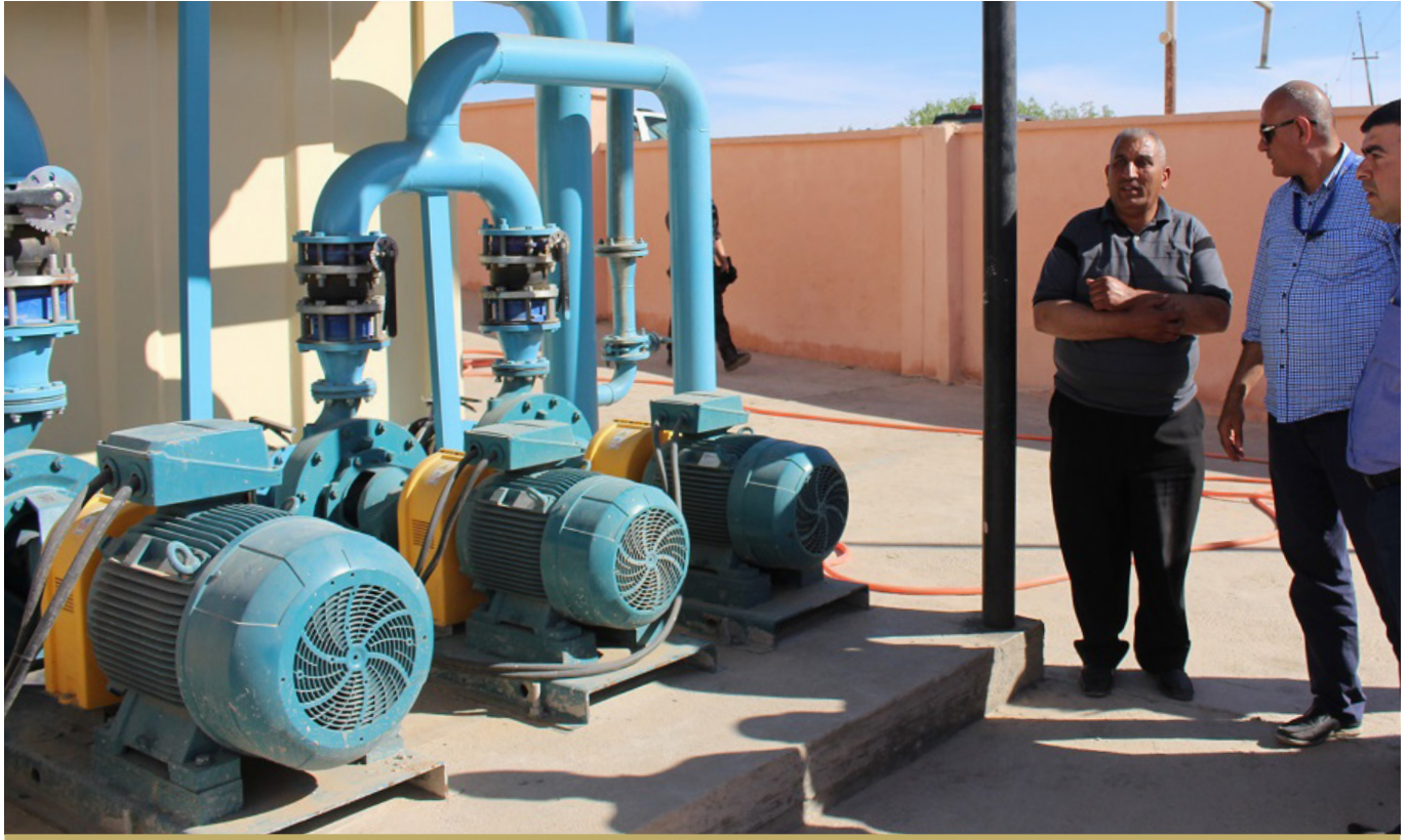
فريق مشروع إعادة الاستقرار للمناطق المحررة يزور محطة مكيشيفة لمعالجة المياه. © برنامج الأمم المتحدة الإنمائي في العراق/ باتريك كارول
