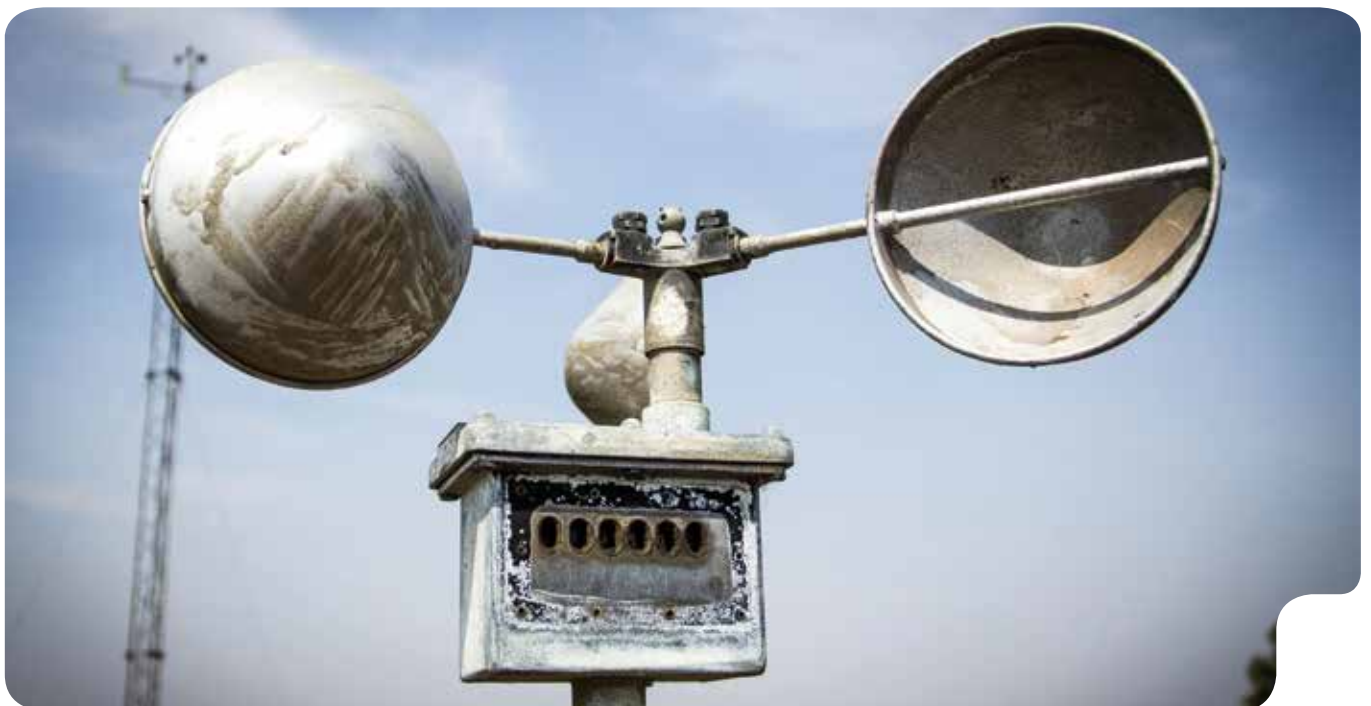
MÊME LORSQU'ILS ONT ÉTÉ CORRECTEMENT INSTALLÉS, LA SÉCURITÉ ET L'ENTRETIEN DES SYSTÈMES DE SURVEILLANCE MÉTÉOROLOGIQUE ET CLIMATOLOGIQUE REPRÉSENTENT DES DÉFIS PERMANENTS, COMME L'ILLUSTRE CET ANÉMOMÈTRE ENDOMMAGÉ. CRÉDIT PHOTO : JOOST HOEDJES
