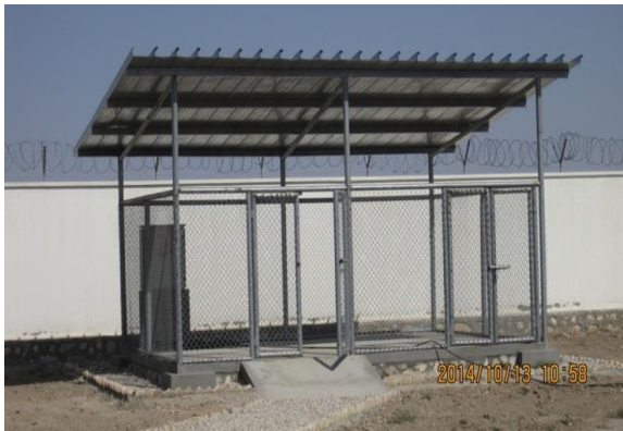
Jowzjan generator shelter
