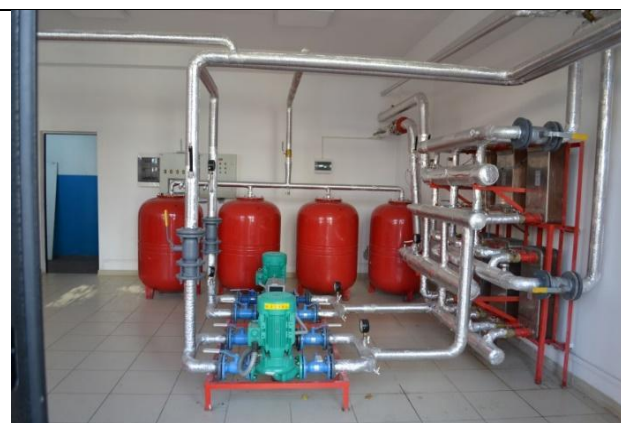
Система с теплообменниками и насосами на котельной «Ротор»
