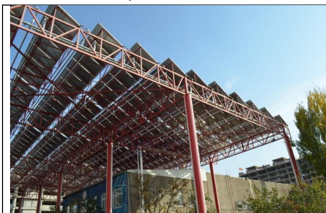
Структура с 396 плоскими солнечными панелями в котельной «Ротор».
