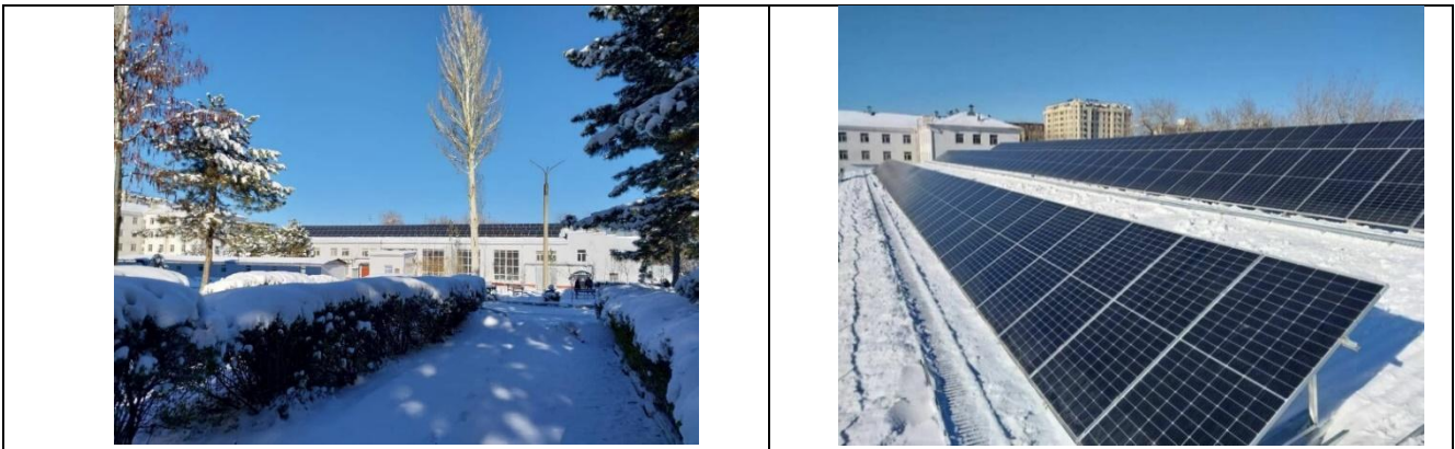
ФЭС 80 кВт на крыше учебного корпуса КГТУ, 2024
