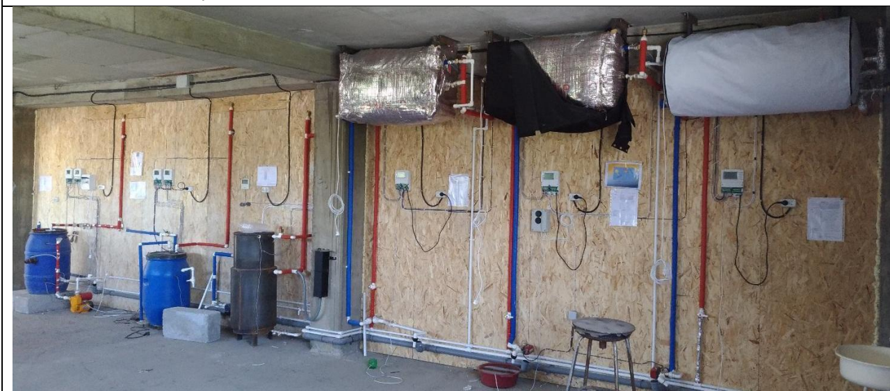
Баки и измерительное оборудование водонагревательных установок на основе технологий обратного и внешнего слива
