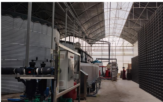
Фото 9. Установка обратного осмоса
