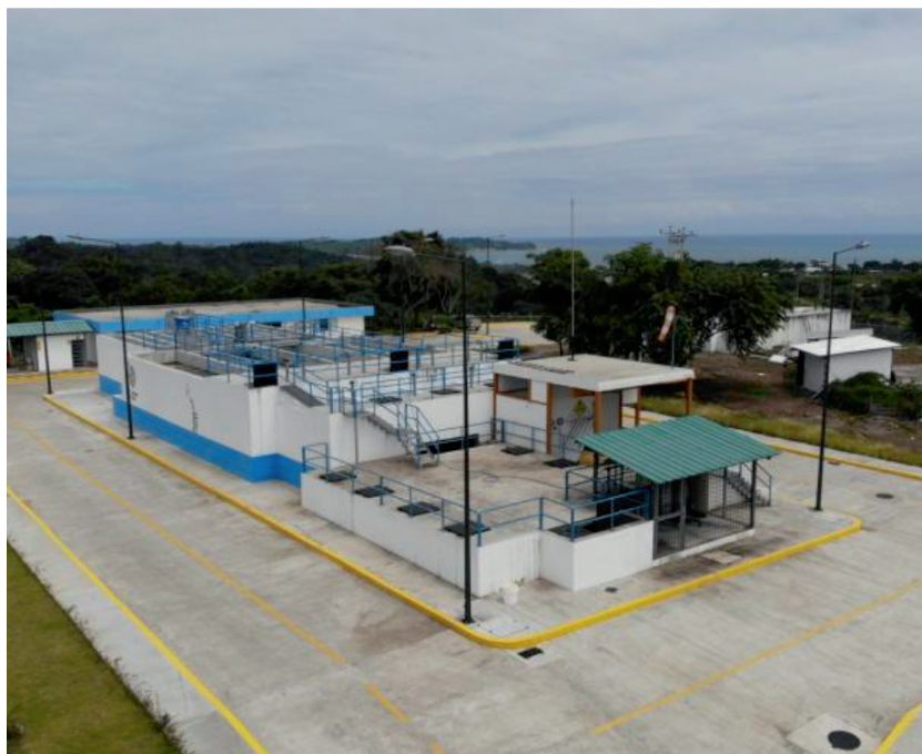
Planta de tratamiento de Pedernales.. La estructura existe pero adolece de una operación adecuada.
