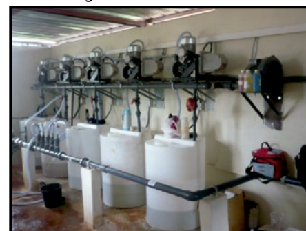
Sistema de fertirriego.
