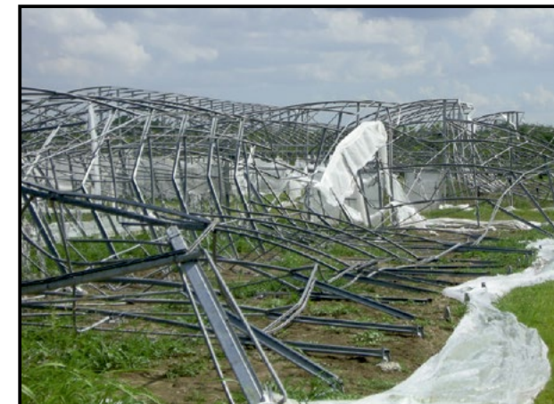
Afectación de instalación por huracán.
