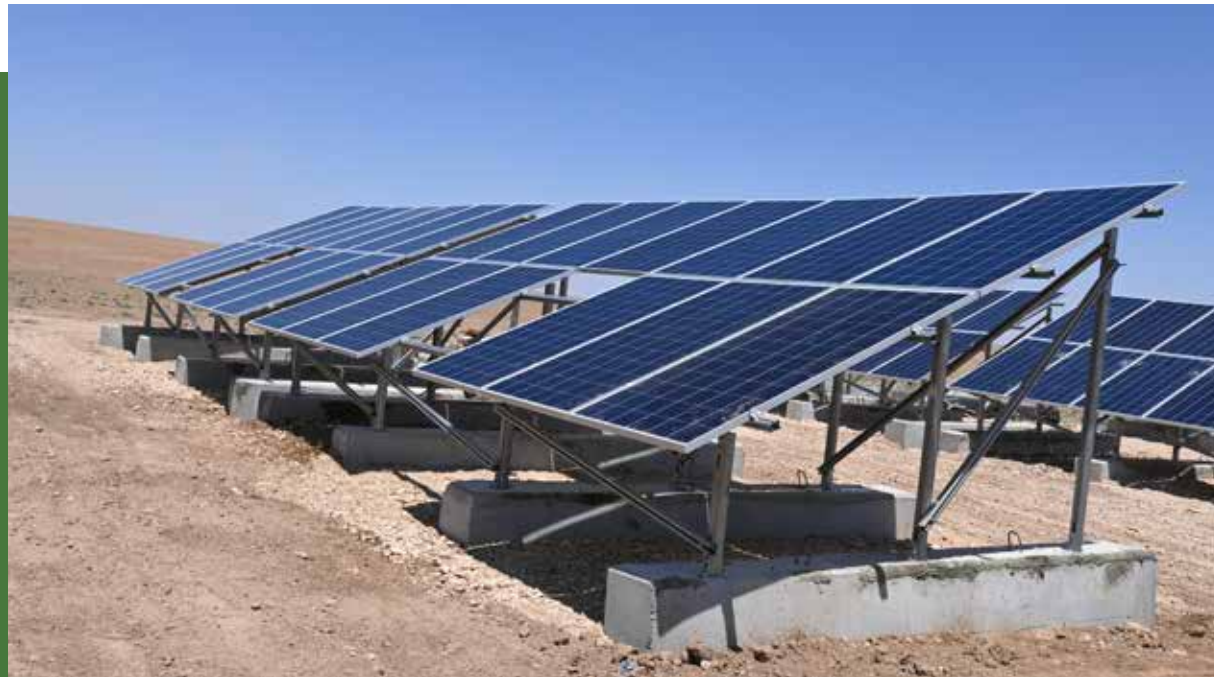
ガザに設置された太陽光発電パネル。 写真: UNDP/PAPP
