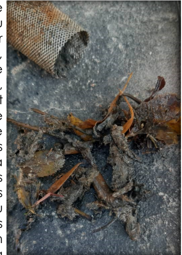
Filtres à eau sales
