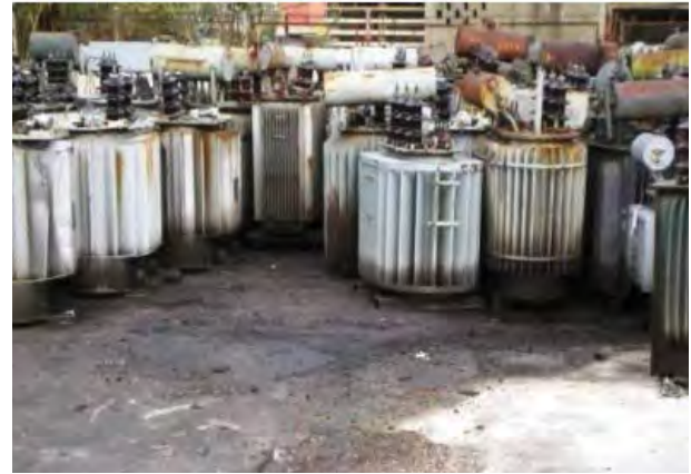
صورة ١٠-١٢. مركز تخزين البوشرية الذي يظهر تسرب الأرض وتسرب الزيوت
