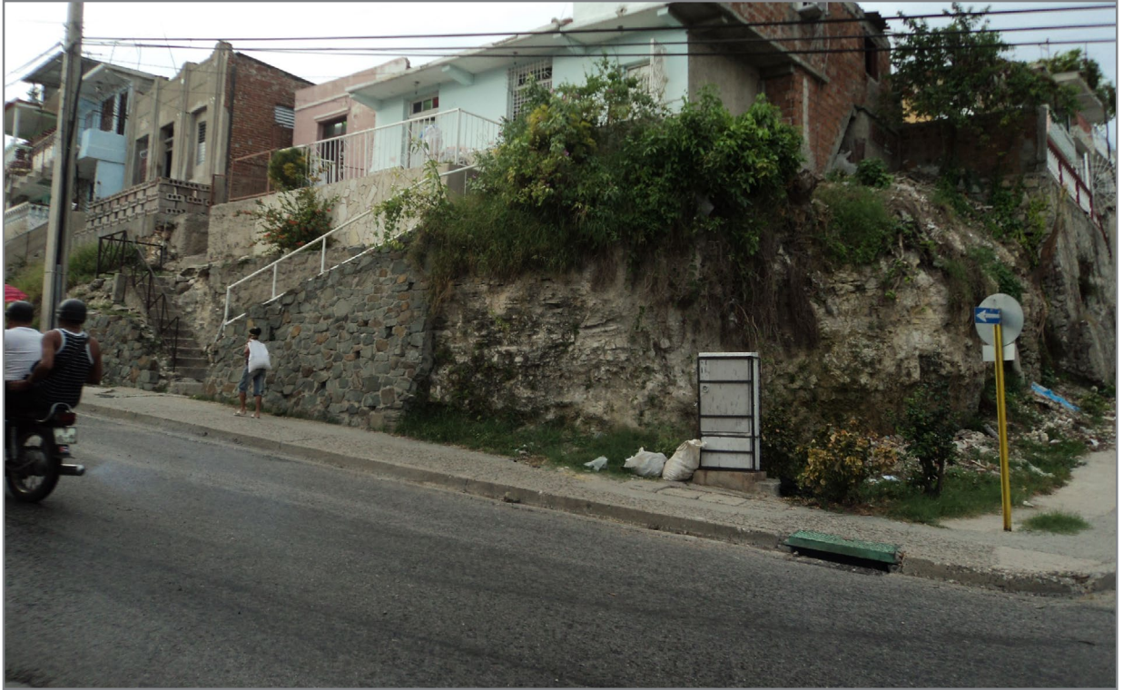
39. SUBZONA MARIANA DE LA TORRE (OBSERVESE LOS TALUDES SIN TRATAMIENTO Y LAS FUERTES PENDIENTES)
