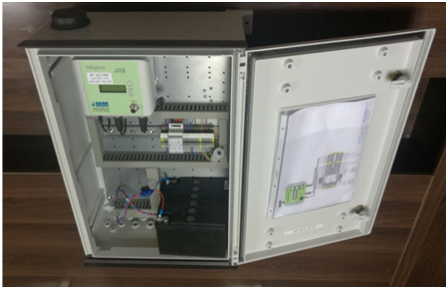
FIGURA 6. GABINETE DE PROTECCIÓN CON ANTENA, REGISTRADOR/TRANSMISOR DE DATOS, CARGADOR Y CABLEADO INSTALADOS.
